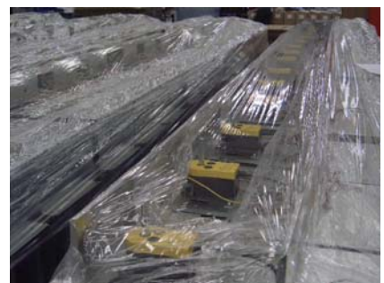
(b) VAV安装前
